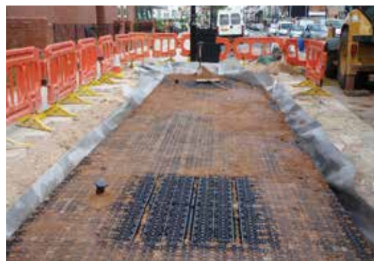
Tapis de caissons minces intégrant les tubes du système d'irrigation et aération. Image : South Tyneside Council
